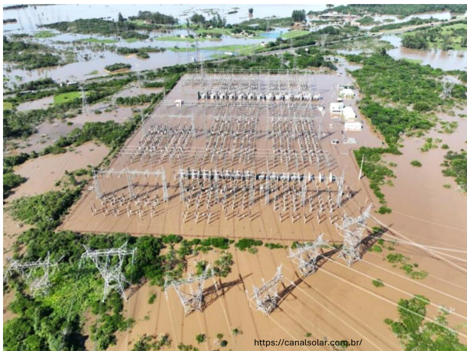
Subestação Nova Santa Rita (RS, nov/2023)
